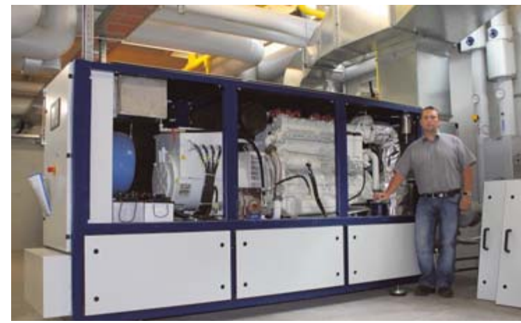
2 Die Stadtwerke produzieren auch dezentral, das heißt selbst, Strom. Und Wärme: Das Blockheizkraftwerk (BHKW) beim Schulzentrum Tiengen ist seit Dezember 2010 in Betrieb. Hier ist die größere der beiden Kraft-Wärme-Koppelungsanlagen (Leistung: 207 Kilowatt thermisch, 135 Kilowatt elektrisch). Andreas Schillinger, Leiter Produktion, steht neben dem erdgasbetriebenen Sechszylinder-Motor. Dieser treibt einerseits einen Generator an (links), der durch die schwarzen Kabel Strom direkt in das Ortsnetz einspeist. Zum anderen erwärmen die Abgase Wasser auf rund 80 Grad Celsius. Dieses erwärmte Wasser gelangt über ein Rohrsystem zu den Abnehmern des BHKW wie die Schulen im Schulzentrum und auch anliegende Wohnhäuser und sorgt so für beheizte Zimmer. Danach fließt das abgekühlte Wasser zurück ins BHKW.
