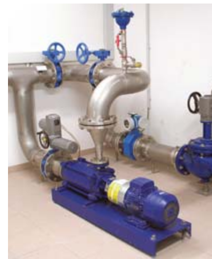
Strom durch Wasserkraft: Im Hochbehälter Dorfhalde in Waldshut treibt durchströmendes Quellwasser die blaue Turbine (am Boden) an. Ihre Leistung beträgt bis zu drei Kilowatt, die direkt ins Stromnetz geleitet werden. Im Jahr werden circa 22 000 Kilowattstunden erzeugt. Zum Vergleich: Eine vierköpfige Familie verbraucht im Jahr rund 4000 Kilowattstunden Strom.
