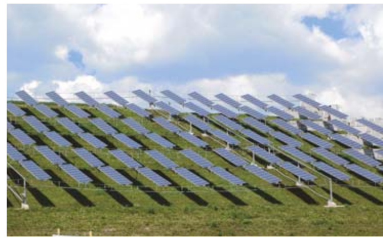
Strom durch Sonnenkraft: Mit Photovoltaik (PV) erzeugen die Stadtwerke ebenfalls Strom. Die Anlage bei der Stadthalle in Waldshut wurde im Oktober 2007 in Betrieb genommen, hat eine Leistung von 66 Kilowatt und produziert jährlich 60 000 Kilowattstunden. Die beim Hochrhein-Gymnasium in Waldshut arbeitet seit September 2008, leistet 65 Kilowatt und erzeugt 63 000 Kilowattstunden. Die Photovoltaik-Anlage im Gewerpark Hochrhein (Bild) ist die jüngste Anlage der Stadtwerke. Sie wurde im Dezember 2008 eingeweiht und hat eine Leistung von 650 Kilowatt. Der Anteil der Stadtwerke beträgt 218 Kilowatt. Das ergibt 280 000 Kilowattstunden Energie. Die übrigen 432 Kilowatt gehören zum Anteil des Gewerparks. Zu den PV-Anlagen der Stadtwerke kommen 200 Anlagen von Privatkunden mit einer Leistung von 4000 Kilowatt.
