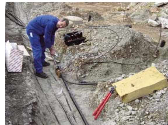
Das Kabelnetz braucht intensive Pflege. Die Stromkabel der Stadtwerke Waldshut-Tiengen sind insgesamt 342 Kilometer lang, davon 84 Kilometer für die Hausanschlüsse, 81 Kilometer für die Mittel- und 177 Kilometer für die Niederspannung. Die Techniker der Stadtwerke müssen ausrücken, wenn ein Defekt die Leitungen lahmlegt. Dann werden die älteren Leitungen durch neue ersetzt. Stadtwerke-Mitarbeiter Franz Brunner ist an einer Baustelle tätig, um defekte Leitungen zu ersetzen, damit der Strom wieder zuverlässig in die Häuser fließen kann.
