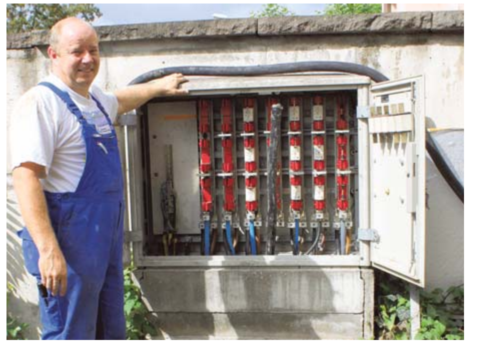
3 Von der Ortsnetzstation zum Hausgebrauch: Elektromonteur der Stadtwerke Jürgen Wagnerbauer hängt das Psychiatrische Zentrum Waldshut-Tiengen ans Netz. Das eine Ende der dicken schwarzen Leitung (Mitte) wird in diesem Verteilerkasten angeschlossen. Die Spannung kommt von der Ortsnetzstation des Landratsamtes, die Leitung dazu ist ganz rechts zu sehen. Das andere Ende der schwarzen Leitung wird mit dem Stromkabel im Psychiatrischen Zentrum selbst, dem Hausanschluss, verbunden, an dem der Zähler angebracht ist.
