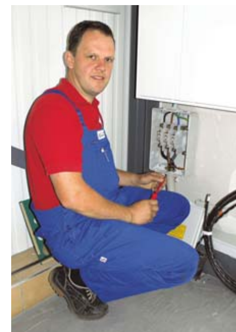
4 Dies ist ein Hausanschluss , wie er in jedem Haushalt zu finden ist. Elektroinstallateur Alfred Marder (links) wird den Anschluss verpöblen, um zu verhindern, dass der bis dahin ungezählte und somit unbezahlte Strom illegal am Zähler vorbeigeführt wird. In der Kernstadt Waldshut-Tiengen gibt es 4772 solcher Hausanschlüsse (Stand 2010). Allein die Kabel aller dieser Hausanschlüsse sind 84 Kilometer lang.
