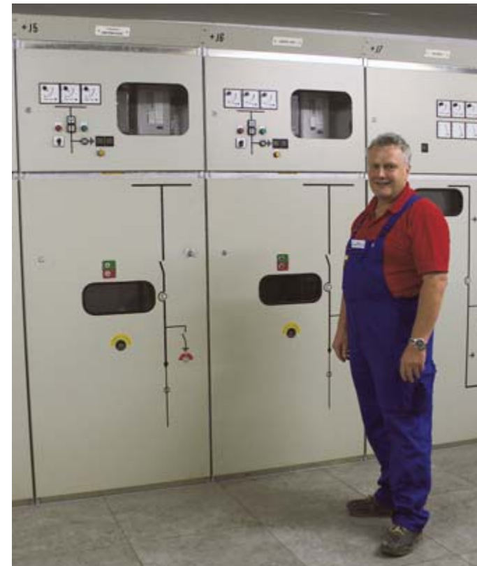
1 Wie hier in der Trafostation Viehmarktplatz wird in 108 weiteren Ortsnetzstationen die Spannung von 20 000 Volt (Mittelspannung) verbrauchsgerecht auf 230 Volt beziehungsweise 400 Volt Drehstrom (Niederspannung) reduziert. Über Schalter wird der Strom an das Netz der Stadt angeschlossen. Durch den Schalter J6, an dem der Stadtwerke-Elektromonteur Franz Welte steht, wird der Strom an die Ortsnetzstation des Landratsamtes in der Waldshuter Kaiserstraße geleitet.
